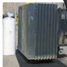
Idealne rozwiązanie pod ciekące transformatory.
